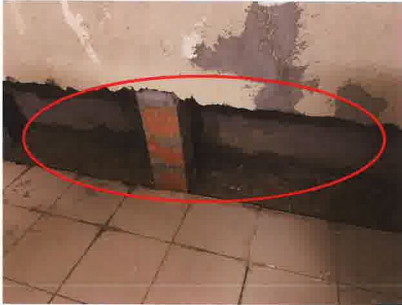
Şekil 6. Bodrum Katları Etkileyen Su Birikintileri
