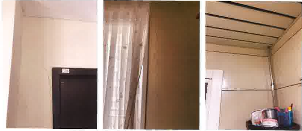
Şekil 11. Duvarlarda Oluşan Çatlaklar
