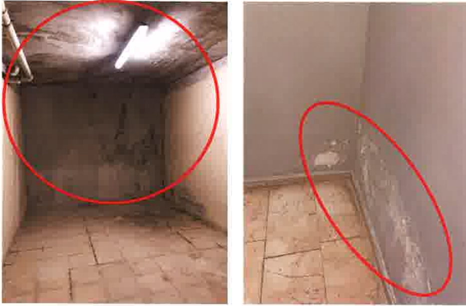
Şekil 5. Bina Bodrumlarında Yoğun Su Hareketleri ve İzleri
