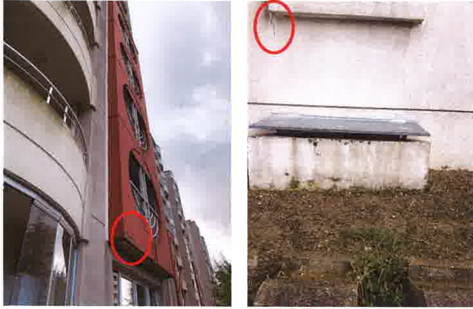
Şekil 4. Dış Cephe Taşıyıcı Olmayan Elemanlarda Çatlaklar
