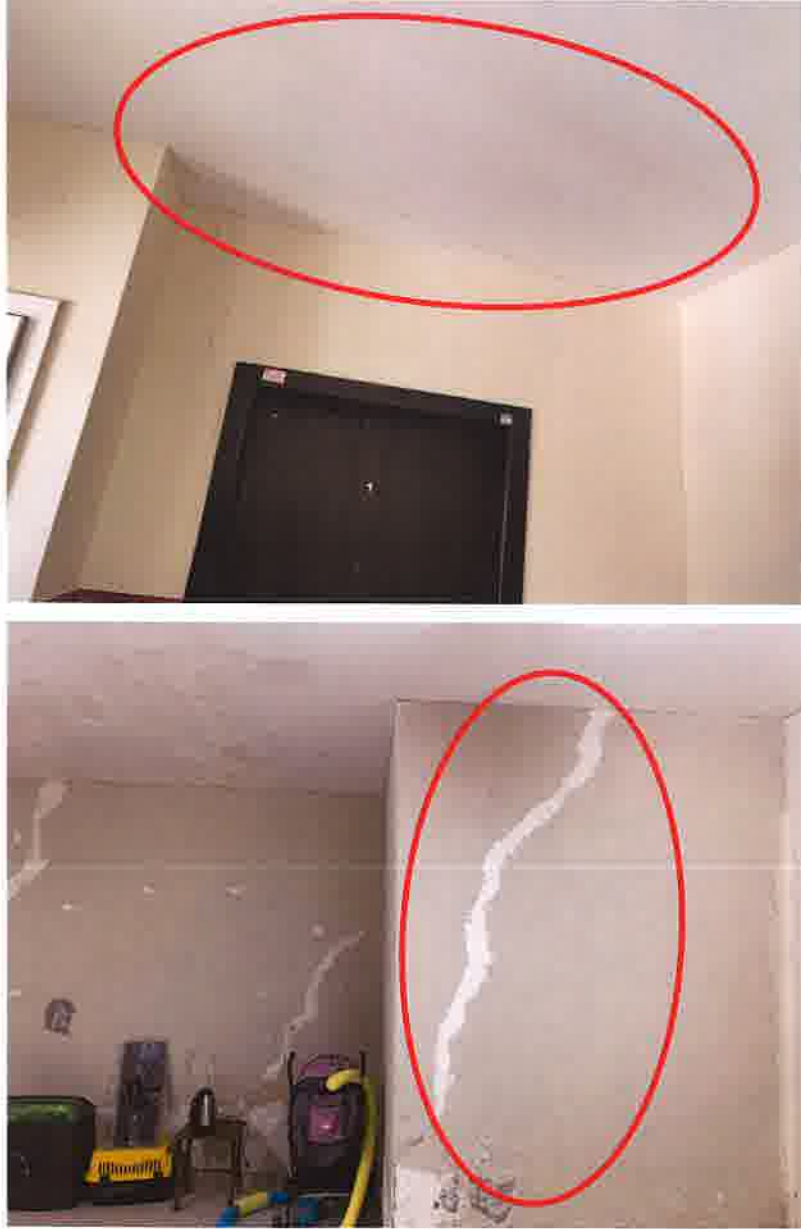
Şekil 7. Taşıyıcı Sistemde Oluşan Çatlaklar
