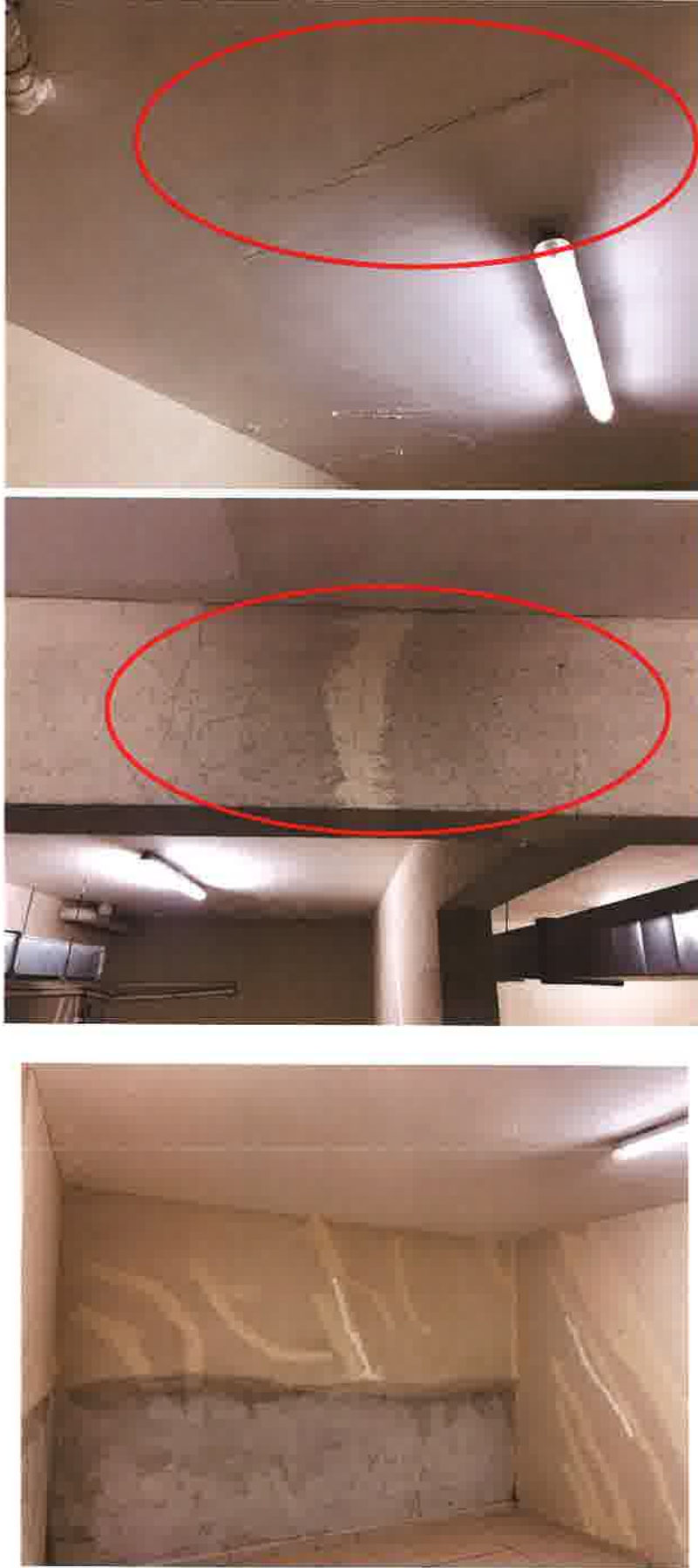
Şekil 8. Taşıyıcı Sistemde Oluşan Çatlaklar
