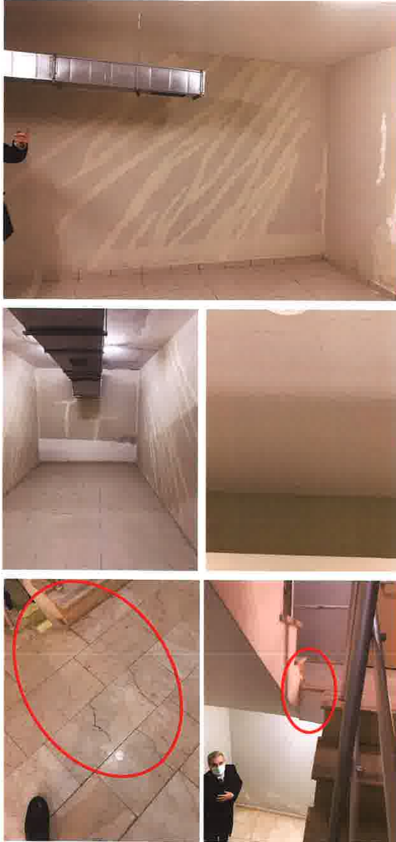
Şekil 9. Taşıyıcı Sistemde Oluşan Çatlaklar
