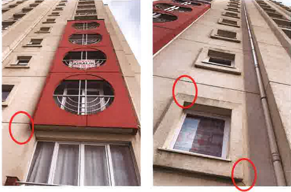
Şekil 2. Dış Cephede Taşıyıcı Olmayan Elemanlarda Zemin ve 1. Katlarda Görünen Kılcal Çatlaklar
