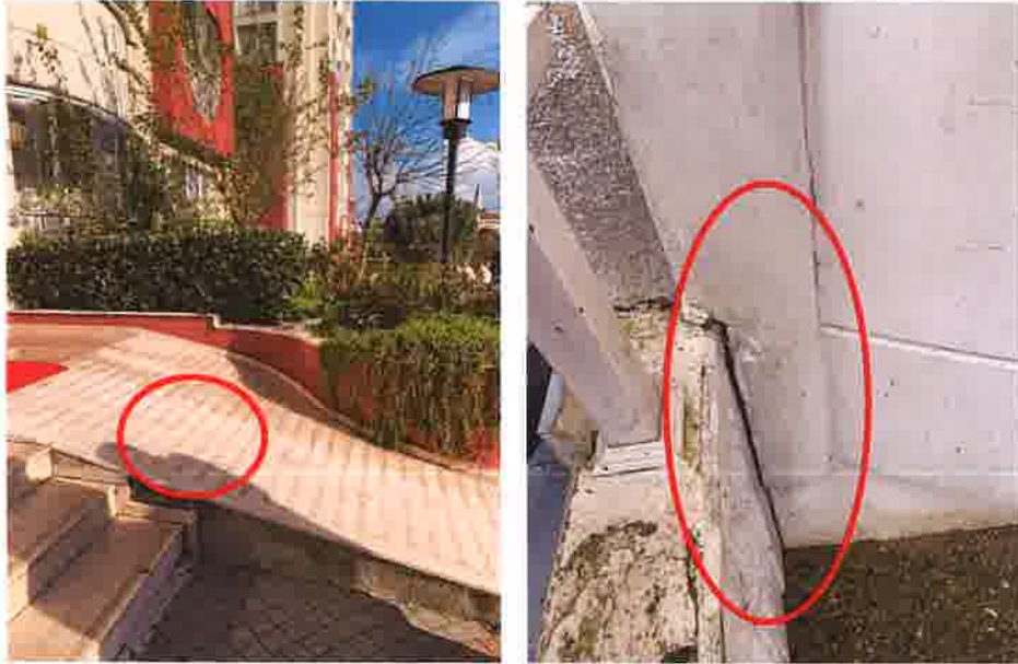
Şekil 3. Dış Cephede Taşıyıcı Olmayan Elemanlarda Çatlaklar
